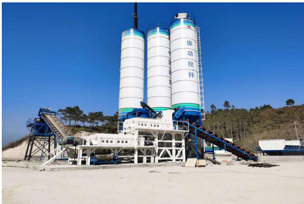
稳定土振动搅拌站
