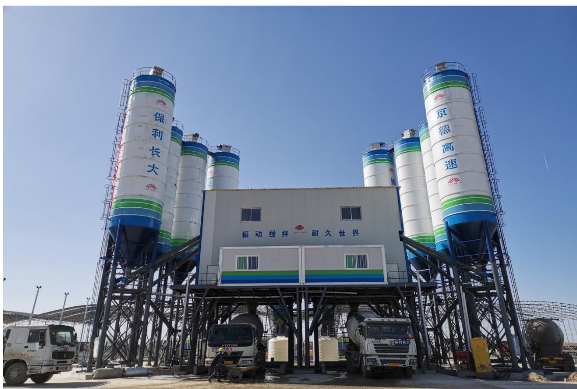
混凝土振动搅拌站
